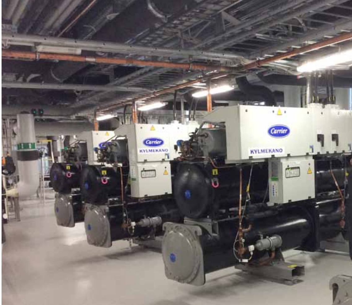
Genom 203 borrhål är Karlstads campus självförsörjande på värme och kyla. När anläggningen togs i bruk 2014 minskade energianvändningen med 70% samtidigt som koldioxidutsläppen reducerades.
